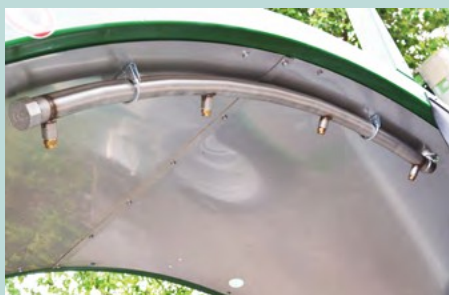
Barra de rociado de agua con boquillas
